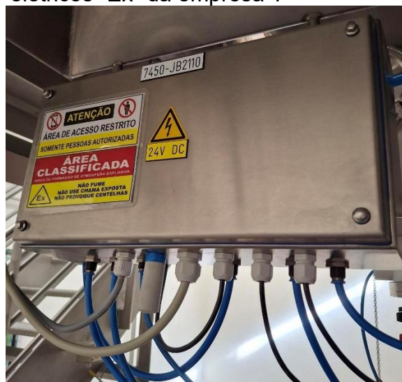
Ilustração 11 – Foto da placa de sinalização presente em um dos painéis elétricos “Ex” da empresa Y
