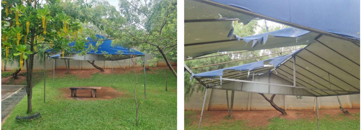
Figura 37 – Local reservado para a futura instalação do Clube de Educação Ambiental (detalhe da cobertura rasgada, à direita)
