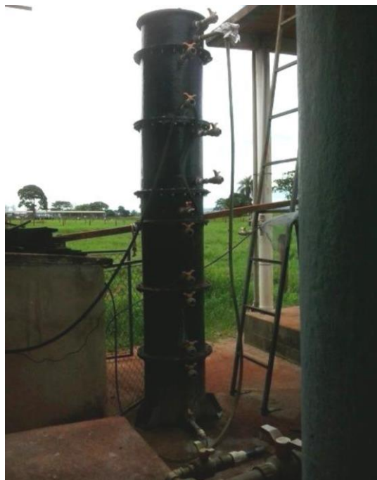
Figura 7 - Biorreator combinado anóxico-aeróbio.
